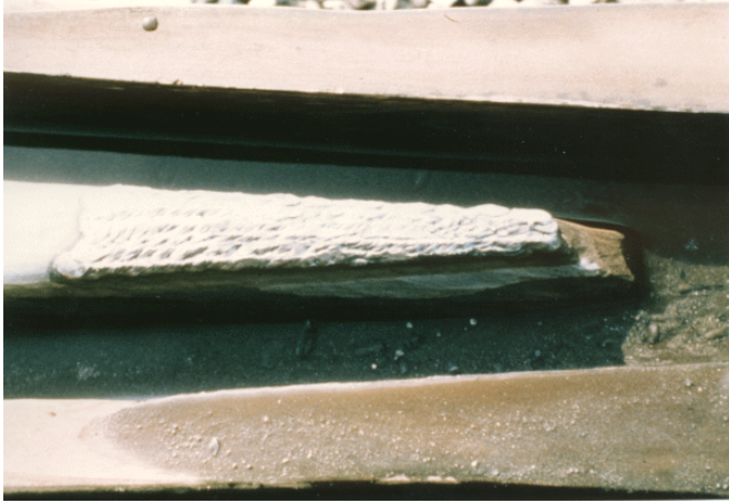
figuur 14.8 Puntstuk van een wissel in de spoorweg bovenbouw
